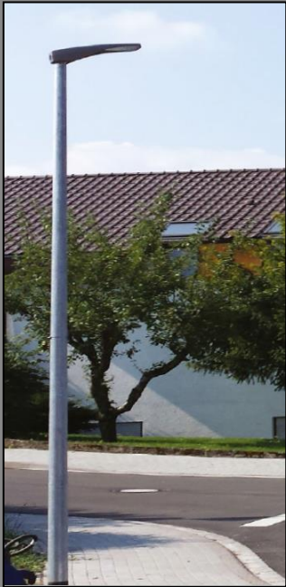
- bevorzugte LED-Außenleuchte d. Stadt Taucha
