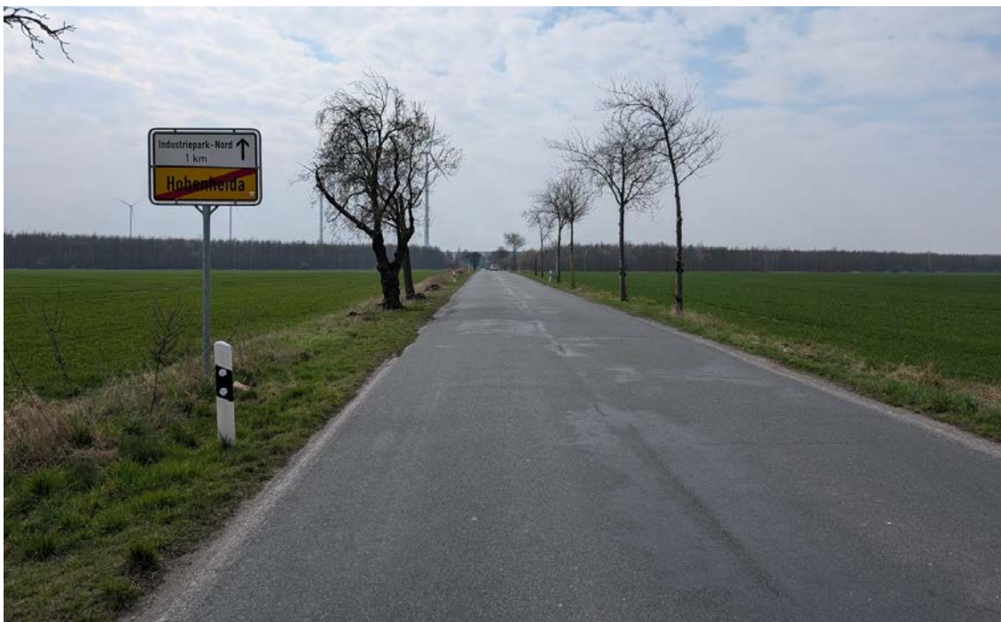
Foto: Hohenheida, Alte Seehausener Straße – schlechter Straßenzustand (IVAS 03/2025)
